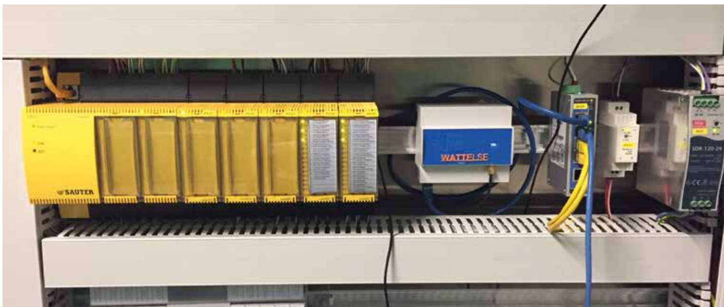
Das Gateway von Wattelse zur Sammlung aller notwendigen Daten wird über die Projektlaufzeit in den Schaltschrank eingebaut.
